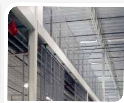
Zwischenböden: Der Schutzzaun auf den Zwischenböden schützt Menschen und Material vor herunterfallenden Gegenständen.
